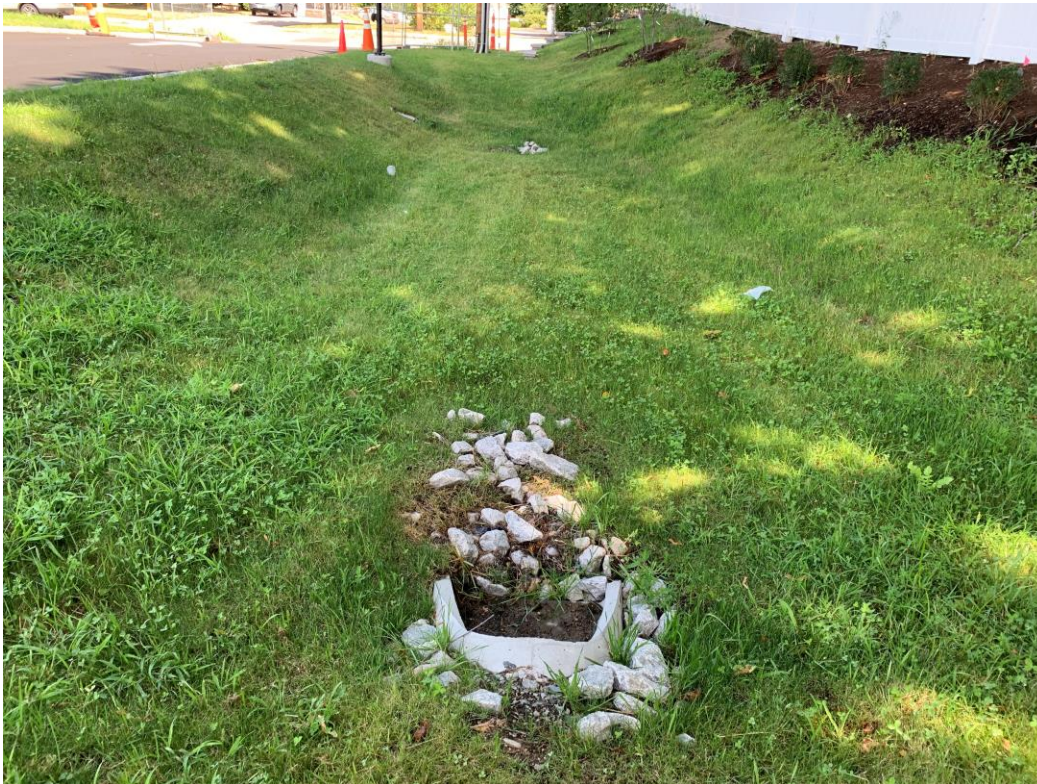
Minimal Rip Rap in Sediment Forebay 1
